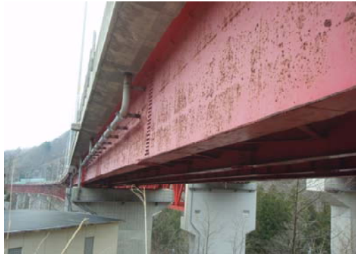
鋼桁の塗装劣化
